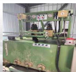
Trạm thủy lực
