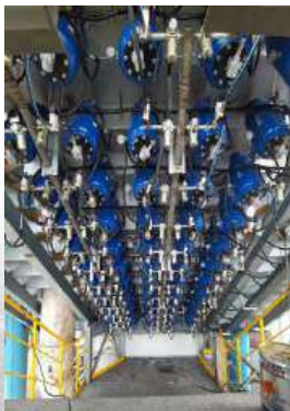
Hệ thống súng bắn khí cannon và cửa đầu vào cấp liệu
