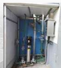
Bơm nước làm mát tuần hoàn trạm thủy lực
