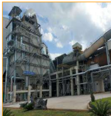
Dự án phát điện nhiệt dư đồng bộ dây chuyền 3 NMXM Xuân Thành 12.500t/d 22MW
